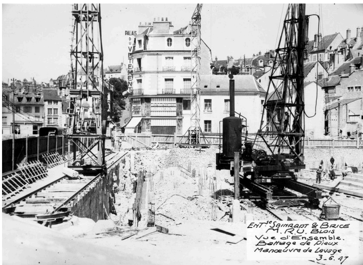
Battage de pieux, manoeuvre de levage, 3-06-1947 (Archives départementales de Loir-et-Cher, Blois, 1195 W 44).
