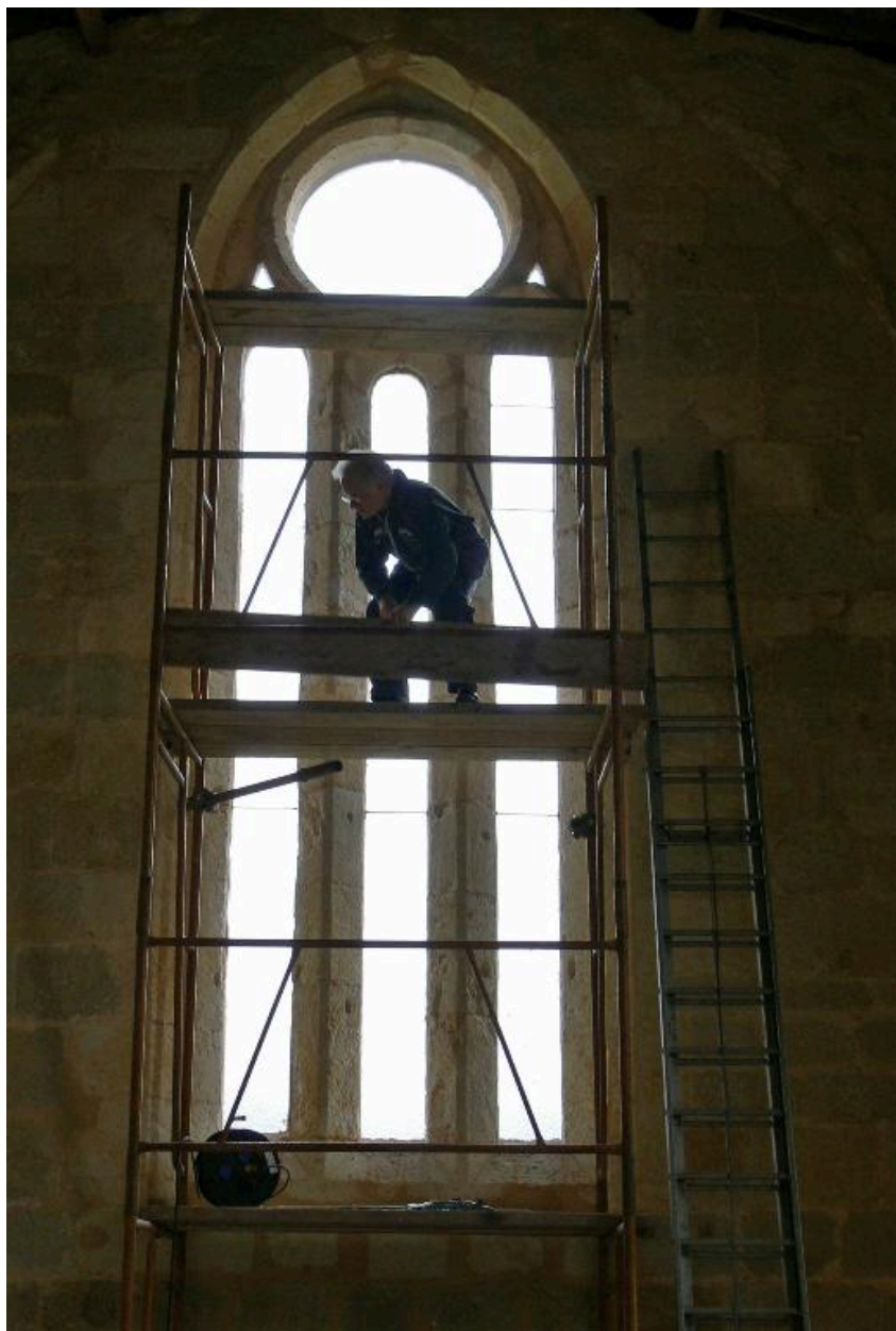
Pose des vitraux de l'église de Chierzac à Bedenac (Charente-Maritime) réalisés par Jean Mauret en 2006. Baie est et échafaudages.
